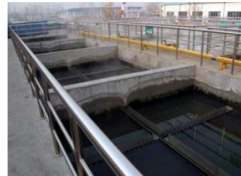
(f) 污水处理池
